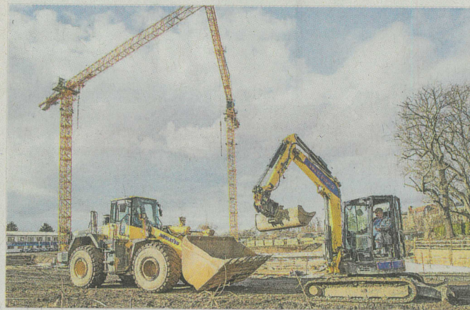
Die Baugrube ist ausgehoben, jetzt startet der Rohbau für die vier Gebäude von Marina Garden.
